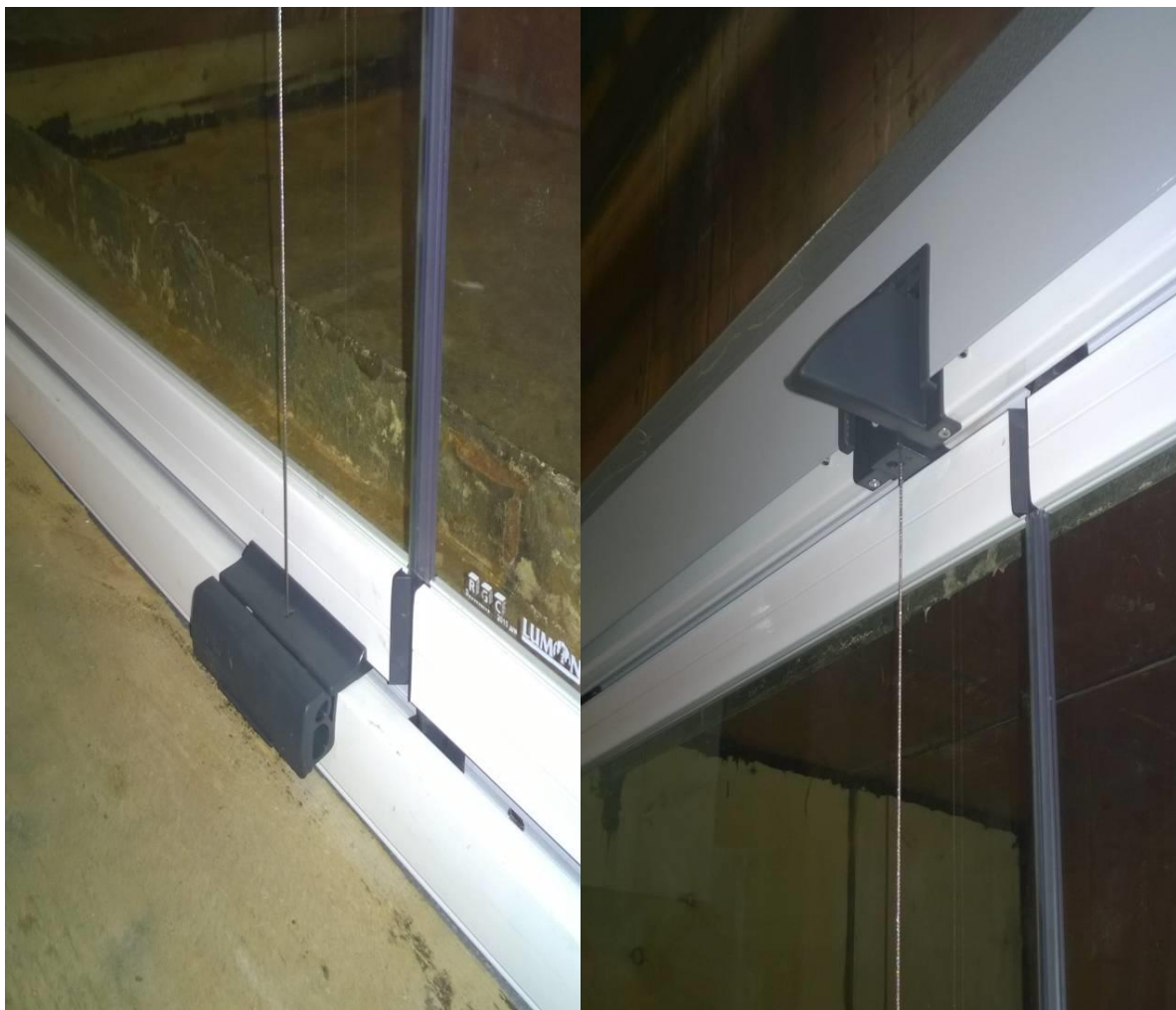
Состояние замков конструкции светопрозрачной для безрамного остекления балконов и лоджий системы «Limon 5L» после проведения испытаний на работоспособность при \Delta P = \pm 600 Па.
